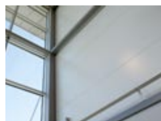
Plannja Panel 1200T. Fondvegg i Nordby kjøpesenter. Valget ble liggende, klarhvit Plannja Panel 1200T med diskret dekorlinje.
